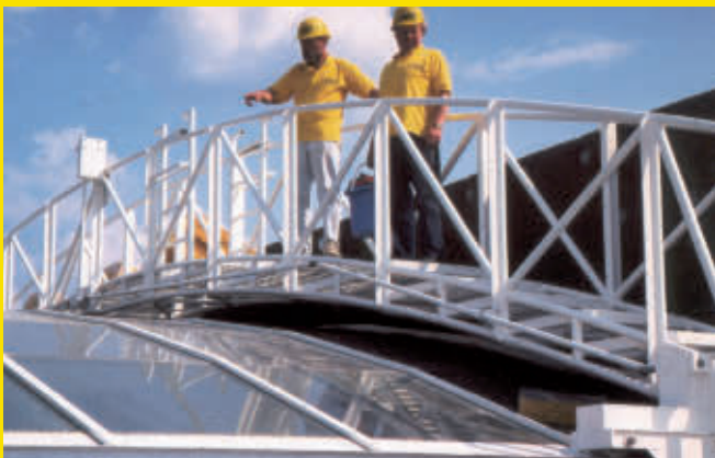
Befahranlage außen am Glasdach für die japanische Botschaft in Berlin
