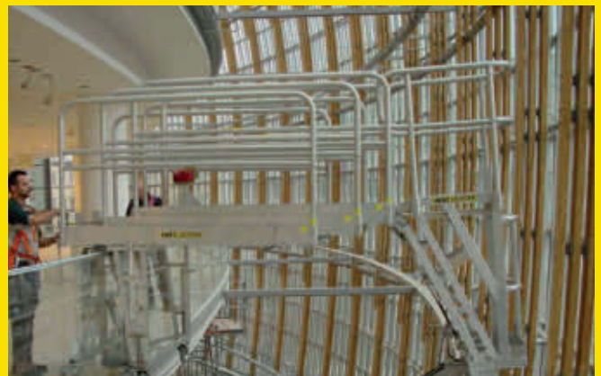
Fassadenreinigungsanlage innen für Peek&Cloppenburg in Köln
